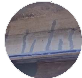
Fisuras y grietas
