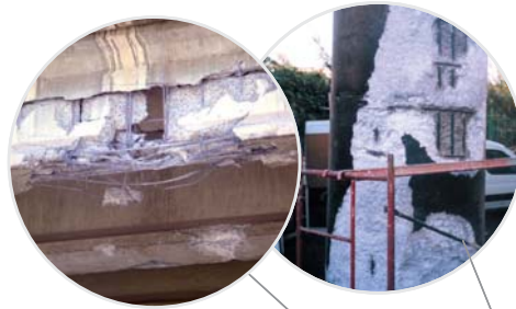
Impactos en vigas y pilas
