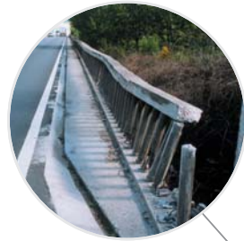
Impactos en barandillas
